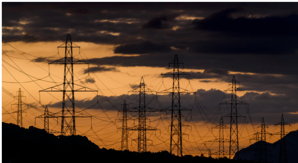
Des pylones électriques à Collonges, en Valais, fin mai 2022. — © JEAN-CHRISTOPHE BOTT / KEYSTONE
