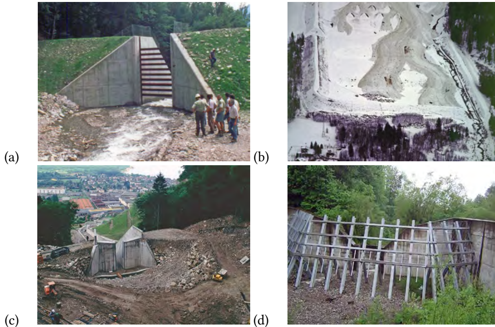
Figure 3.6 – (a) Plage de dépôt du torrent de Saint-Clément à Tours-en-Savoie (Savoie); (b) dispositif paravalanche de Taconnaz entre les Houches et Chamonix-Mont-Blanc (Haute-Savoie); (c) construction du barrage de rétention sur le torrent du Pissot (Vaud) au-dessus de Villeneuve après la crue de 1995; (d) barrage-grille format un « dépotoir » à sédiment à Sachseln (Obwald) cliché Andreas Götz (OFEG).
