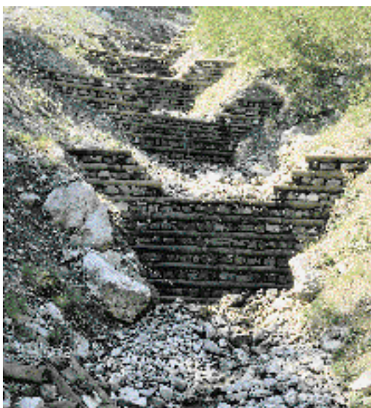
Fig. 7d : Rivière de montagne avec des seuils artificiels pour réduire le charriage et une stabilisation des berges et du fond
