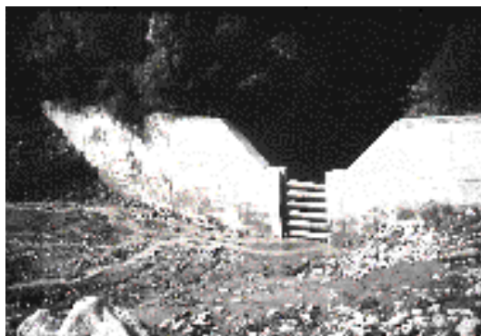
Fig. 10b: Barrière à alluvions
