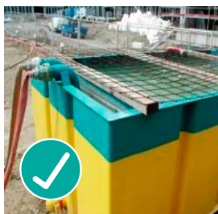
Alimentation devant le déflecteur/la paroi de plongée bassin de décantation recouvert avec une grille (protection contre la noyade)
