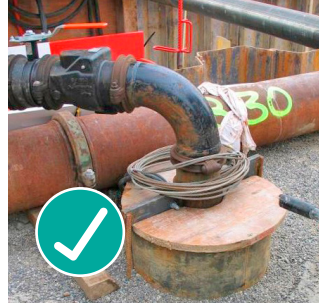
Puits filtrant couvert
