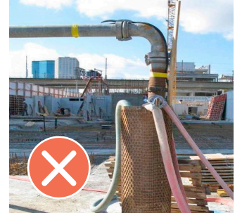
Pas de rejet des eaux de fouille dans la nappe phréatique !
