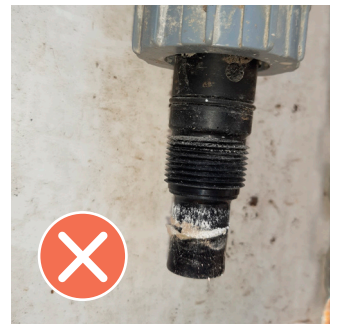
Sonde pH contaminée
