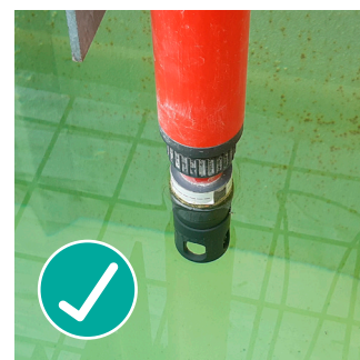
Sonde de mesure du pH dans l'eau du bassin
