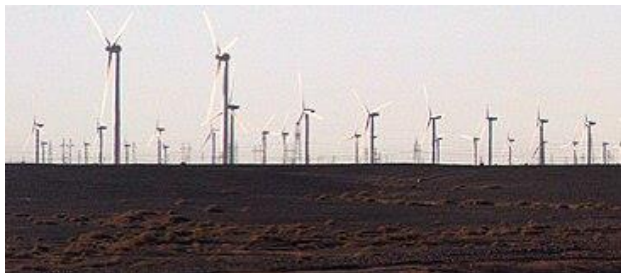
Ferme éolienne de Gansu, Chine Puissance: 10 GW
