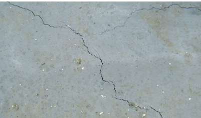
Fissures typiques dues au retrait plastique en raison d'une dessiccation précoce de la dalle de béton
